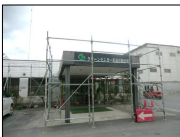
復興作業を優先し、震災の影響で破損された事務所は現在、補修作業の最中でした。
