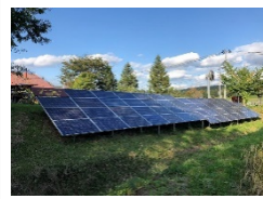
「なのがなソーラー」2号発電所
