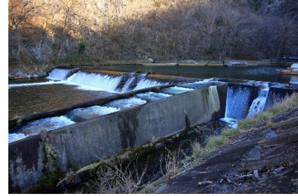
▲東山町の松川堰。砂鉄川から取水しています(向かって右側が取水した堰)。
